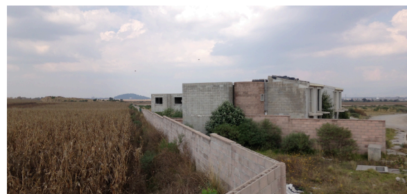
Mezcla de suelo y obra detenida.
